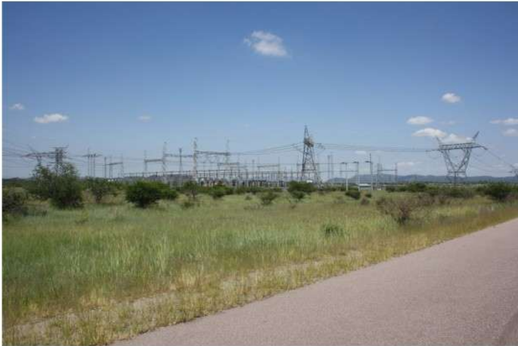
VIEW I: DINALEDI SUBSTATION
